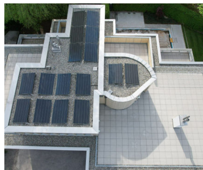
Dach mit Photovoltaik
